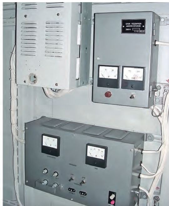
Блоки стабилизации напряжений, подзаряда аккумуляторов и щит переключений
