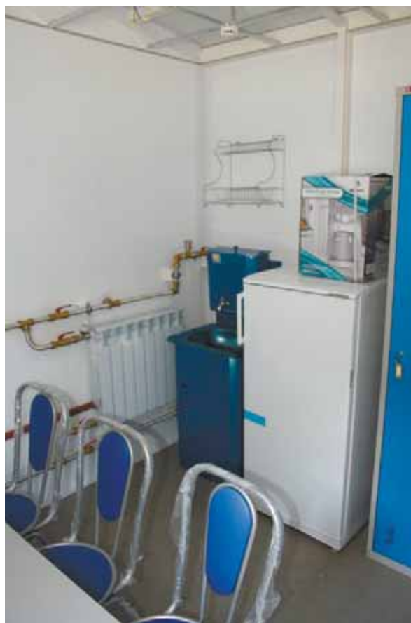
Блок-боксы бытовых помещений АГРС «Саратов-70М»
