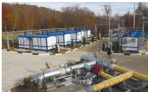
АГРС Адлерского района города Сочи. Блок-боксы редуцирования. Узел переключающих кранов подогревателей газа
