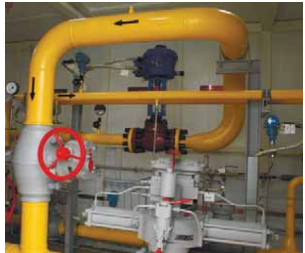
Узел переключения АГРС «Саратов-10» Автоматическая байпасная линия
