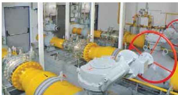
Зал редуцирования АГРС, производительностью 120 000 м 3 /час
