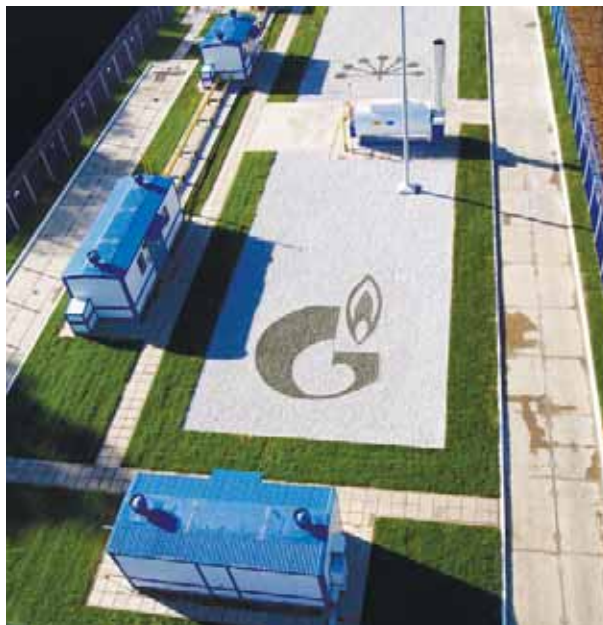
Оборудование АГРС «Саратов-70(М)» на площадке эксплуатирующей организации
