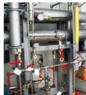
Блок одоризации БО-М в утепленном шкафу
