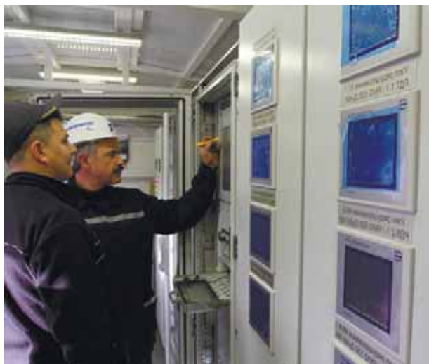
Блок-бокс КИППиА АГРС Адлерского района города Сочи. Отладка Оборудования САУ ГРС
